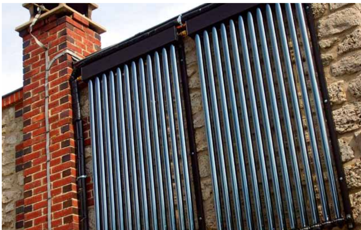
Un chauffe-eau solaire individuel installé chez un particulier, à La Ferté-Alais (91).
